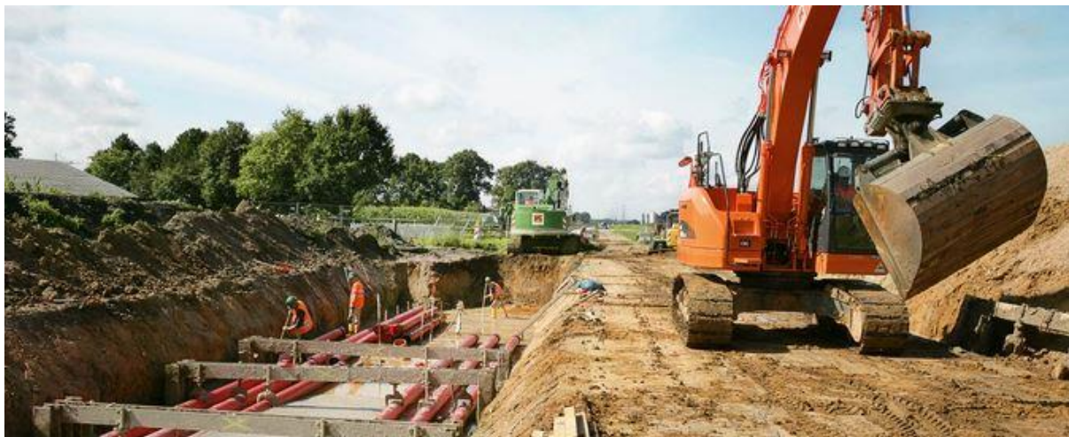
Bild 4.5: Einer von zwei Arbeitsstreifen in Raesfeld, Teilabschnitt Bredenwinkel – Borken-Süd der Leitung Diele – Niederrhein. EnLAG-Vorhaben Nr.5 (Amprion 2015)
