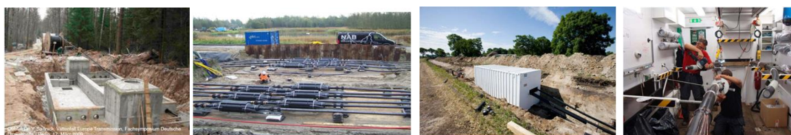
Bild 4.2: Kabelmuffenbauwerk (Hofmann 2015), Kabelmuffenstelle (Siegmann 2013), Muffenmontage im Muffencontainer (Siegmann 2011 aus Scholles et al. 2012)
