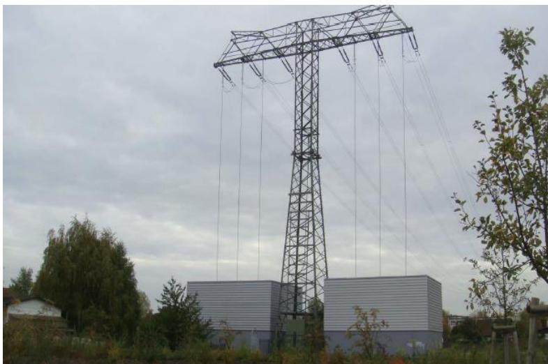
Bild 3.6: Übergang eines Freileitungsdoppelsystems auf ein Kabeldoppelsystem (Bild: 50Hertz)
