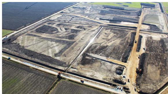
Bild 4.6: Baufeld für das Umspannwerk Emden/Ost inkl. Anlage einer Konverterstation (©TenneT GmbH Bildquelle: www.tennet.eu/de/netz-und-projekte/offshore-projekte/emdenost.html )
